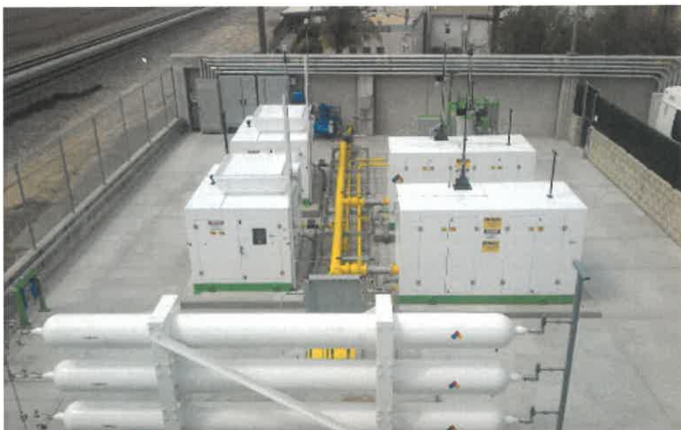
Rysunek 15 Kompresory oraz magazyny buforowe stacji CNG, źródło: http://cngcenter.com/services/cng-station-installation/cngfillstation/
